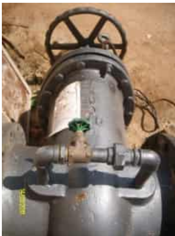
Registro de Gaveta: em 1º plano observa-se o sistema “by pass” composto por tubulação TUPY de ferro maleável, \varnothing = 1 pol, (DN 25 mm) operacionalizado por registro de gaveta em bronze
