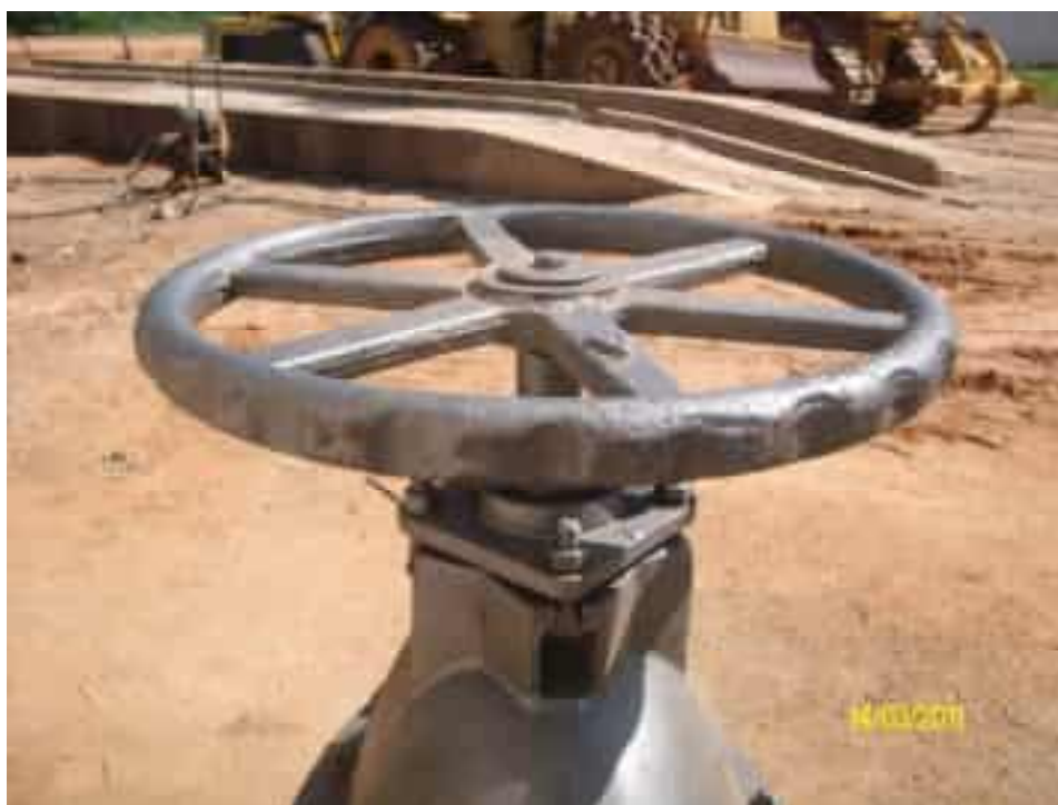
Registro de Gaveta: acionamento direto por volante de manobras. Não há o redutor de engrenagens especificado na planilha orçamentária, referente ao item 5.11
