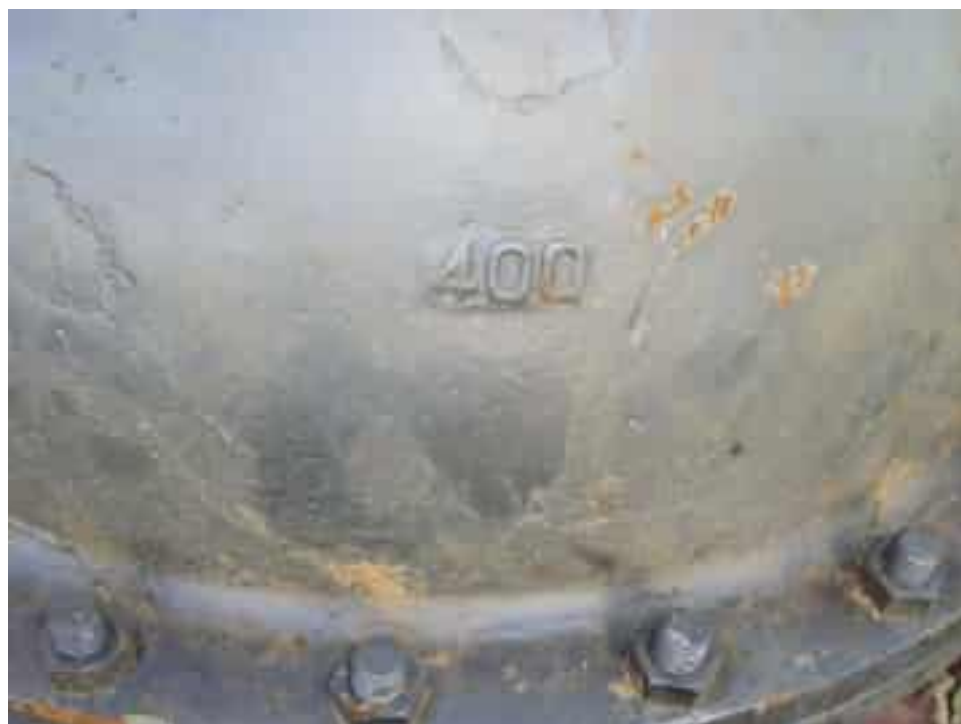
Registro de Gaveta: acabamento apenas regular na superfície fundida
